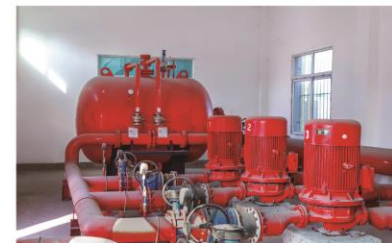
泡沫灭火装置应用现场
