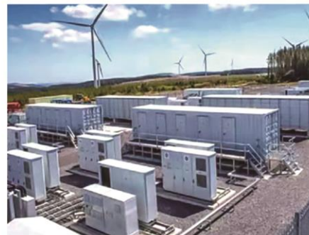
国网丝路网能巴楚县100MW光储并网发电配套储能项目
