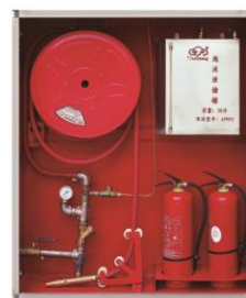
泡沫消火栓箱
