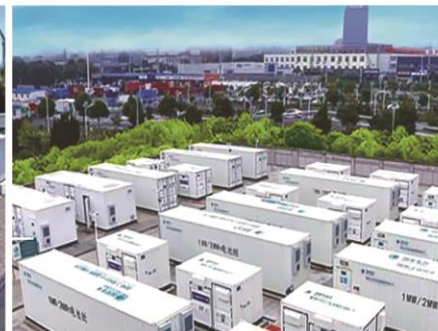
广东汕头中奥天兆一、二、三期储能项目
