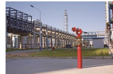
手动式消防水炮应用现场
