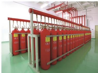
IG541气体自动灭火系统应用现场
